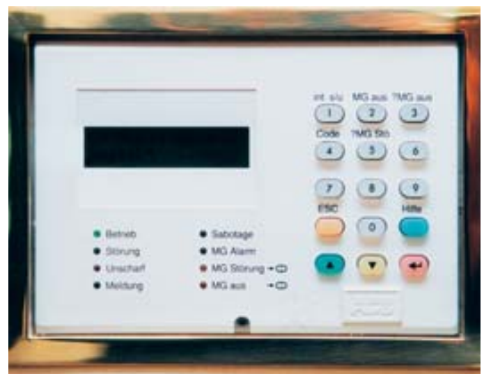
Selbst die Alarmanlage ist edel unter Putz eingefasst.
